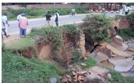
Figure 6 : Impact des changements climatiques sur les infrastructures (destruction d'une route dans la ville de Bujumbura)
