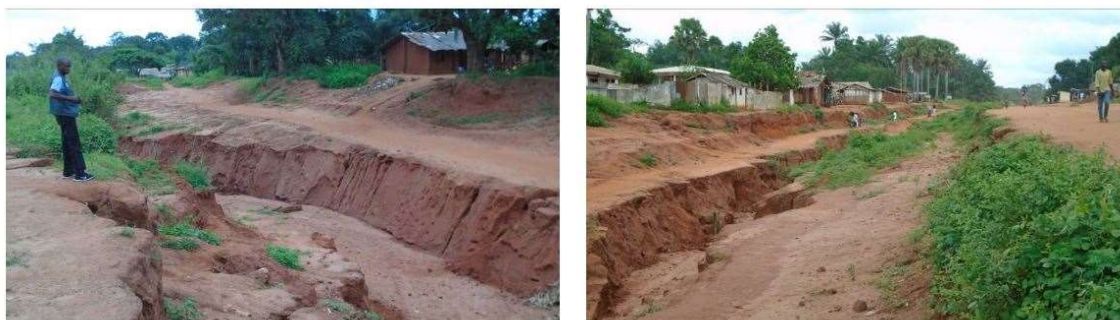
Photo 6 : Erosion d'une route à Berberati par les eaux de ruissellement entraînant son abandon par la création d'une autre. (Mission terrain TNC, mai 2018)
