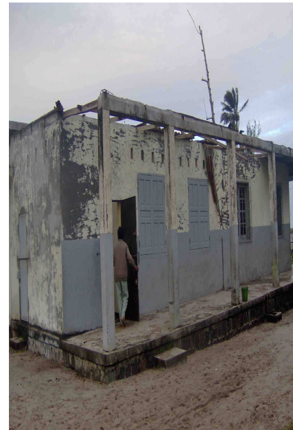
Centre Hospitalier de District après passage de cyclone
