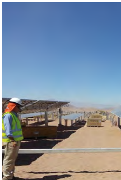
Parque solar Amanecer solar Atacama, CIFES.
