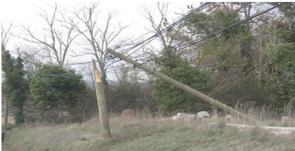
Photo 4.2 : Chute de poteaux électriques causée par les vents violents dans le centre du Bénin
