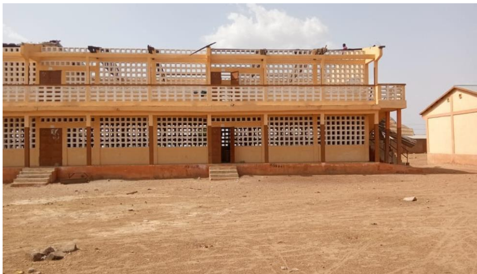
Figure 6 : Décoiffement d'un bâtiment scolaire suite aux vents violents dans la préfecture de Kpendjal en 2021
