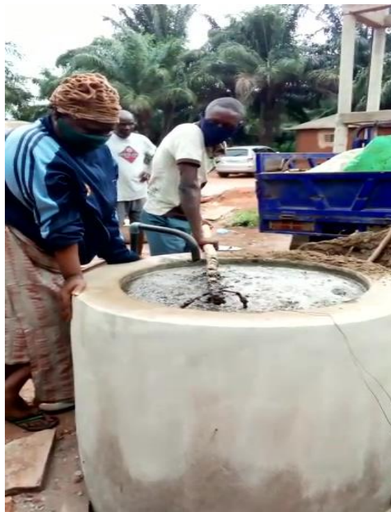
1 er chargement de déchets (épluchures de manioc et bouses de vache) dans le biodigesteur par le bac d'alimentation
