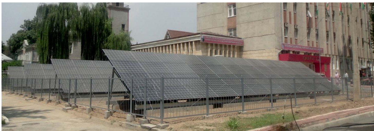
Фото. Солнечные батареи для электроснабжения медицинских учреждений (г. Душанбе)
