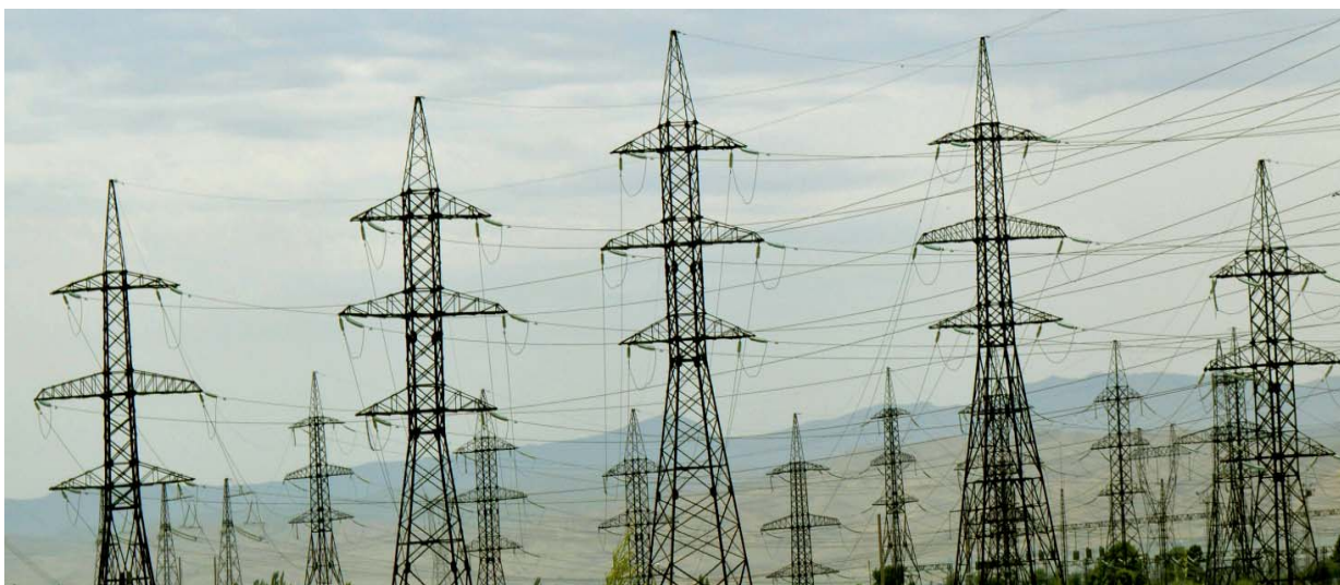
Фото. Линий электропередач
