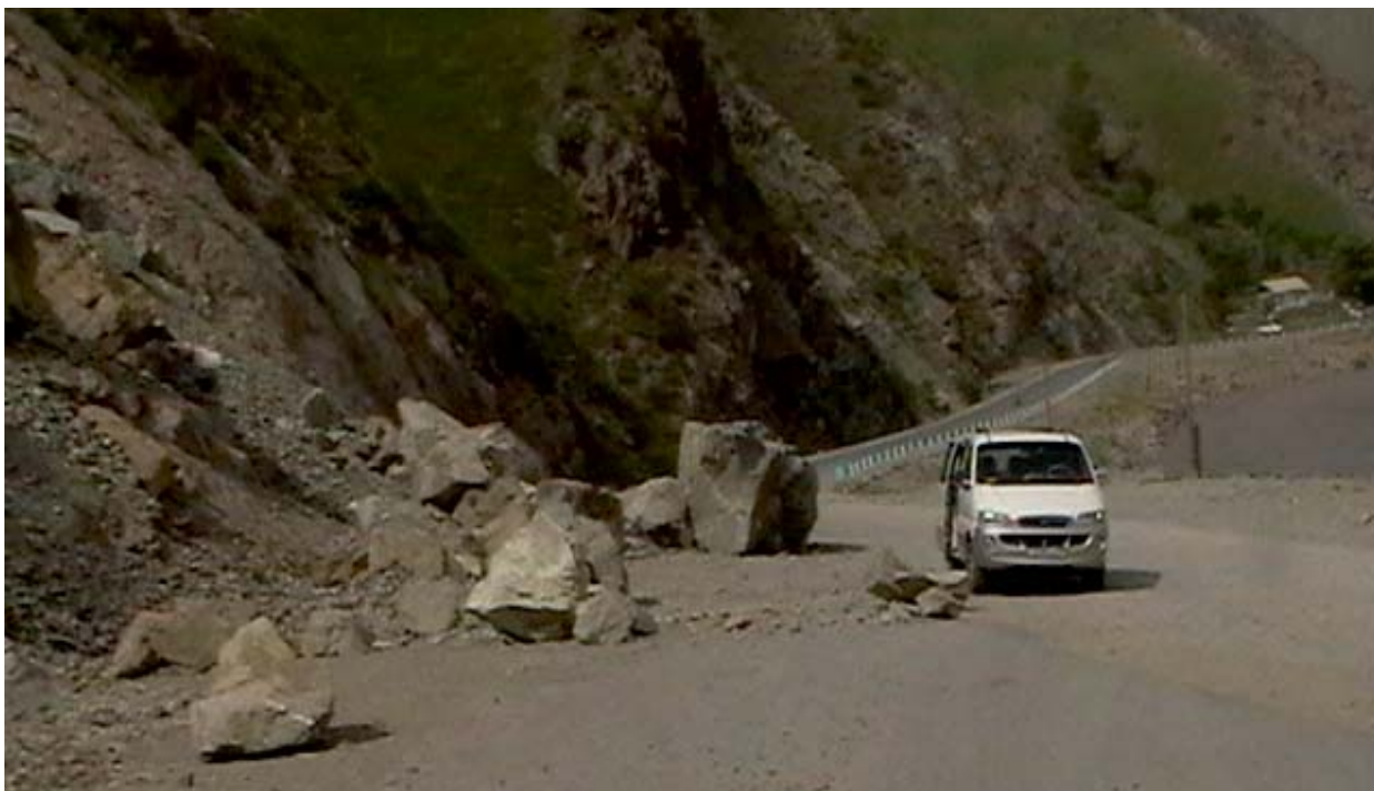
Фото. Обвалы на дороге Душанбе - Хорог
