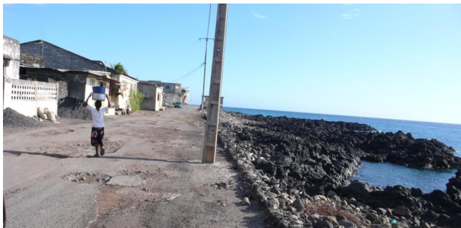
Photo 23 : Mur de soutènement détruit à Iconi
